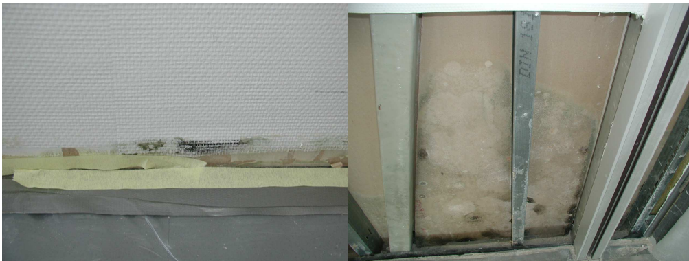
Abbildung 5: Schimmelpilz hinter einer Fußleiste, Offenlegung eines massiven Schimmelpilzbefalls nach Öffnung der Gipskarton-Schale
