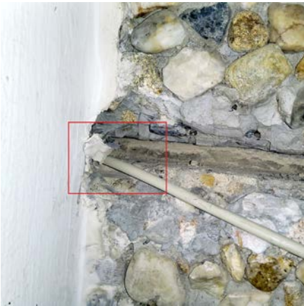
(7) Nicht ausgebaute Reste einer Fugendichtmasse
